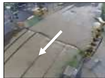
浸水状況(京阪京津線)(R3)
